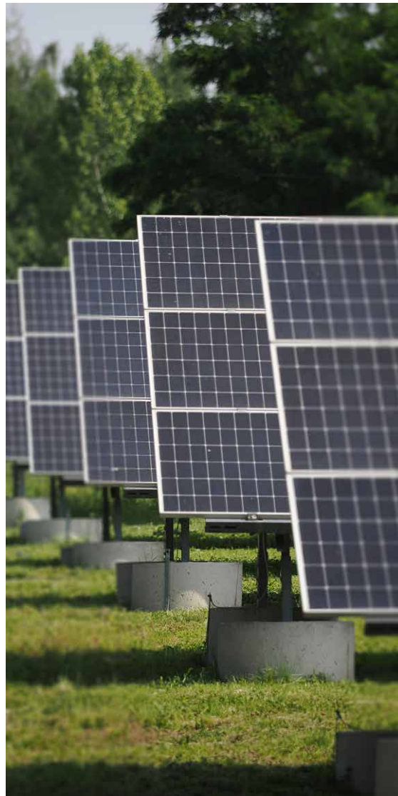
Fot. Błażej Boryń, Farma fotowoltaiczna
